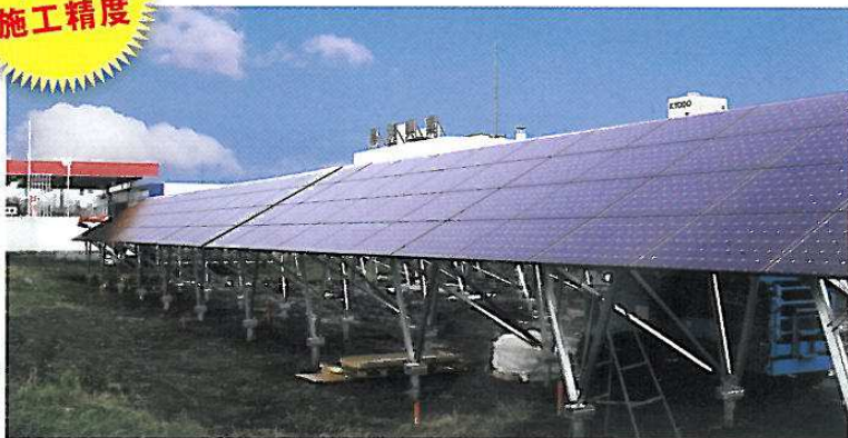
幕別町メガソーラー発電施設
