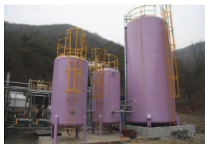
オイルタンク
