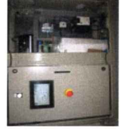
⑧自動制御盤
